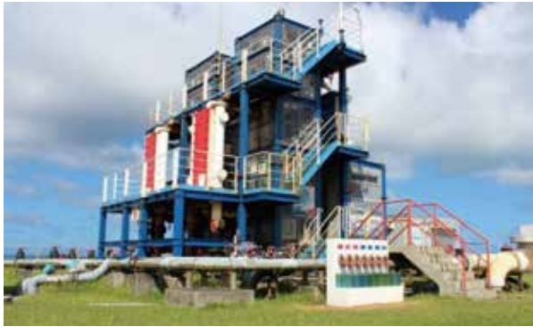
▲沖縄県海洋温度差発電実証試験設備
